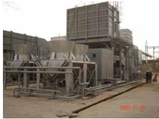
وحدة توليد الطاقة بعد تركيبها
