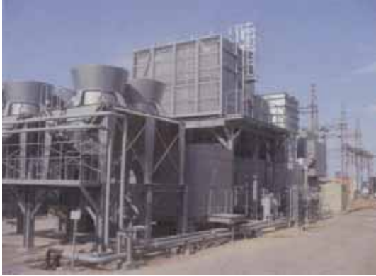
بعد اكتمال منشأة التوليد الكهربائي وحدة رقم 5
