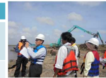
東デメララ野水池 (無償資金協力により整備中)
