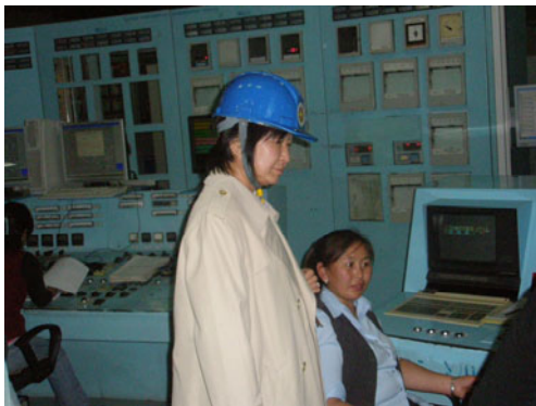
日本の有償資金協力により 改修された制御室で
