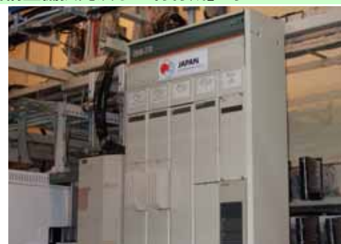
日本が供与した通信網設備
