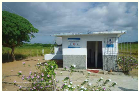
青年の島飲料水供給改善計画で設置されたポンプ場
