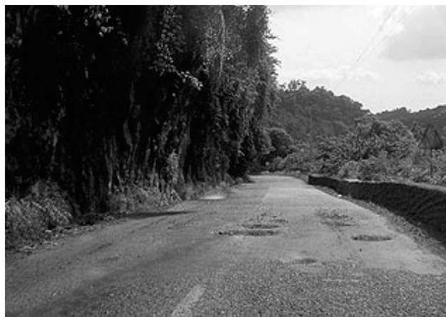
崖が道路にせり出しているケノン道路の現状
