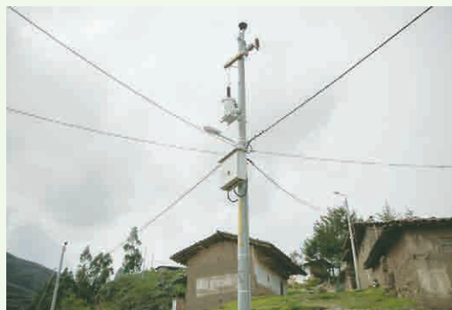
電力フロンティア拡張事業で設置された街灯兼用の電信柱。電気が引かれ、各家庭で電化製品を利用できるようになった(写真: 岡原功祐/JICA)
