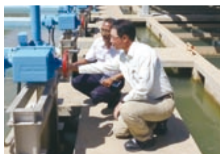
プノンペン市内のプンプレック浄水場で、浄水部長とバルブの更新計画について確認(写真:川崎孝之)
