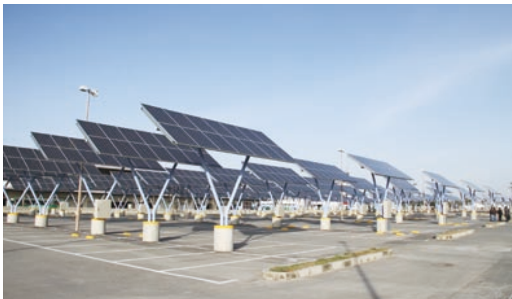
アフガニスタンのカブール国際空港施設内において系統連系型太陽光発電システムを設置。本発電で国際線ターミナルの電力需要の約35%を賄う (写真：サイド・ジャン・サバウーン/JICA)
