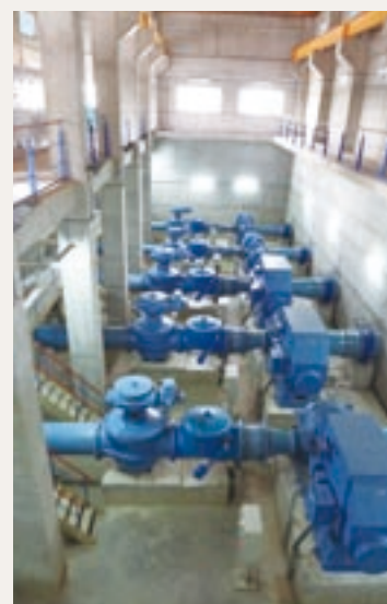
無償資金協力によって整備された給水ポンプ (写真：JICA)
