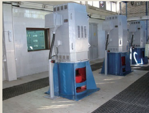
マレザ第2ポンプ場の様子(写真提供: JICA)
