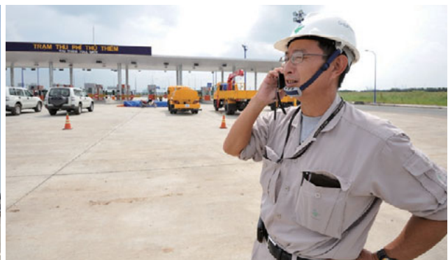
ベトナム「サイゴン東西ハイウェイ建設計画」サイゴン川渡河トンネル料金所にて (ホーチミン市) (写真提供: 佐藤浩治/JICA)
