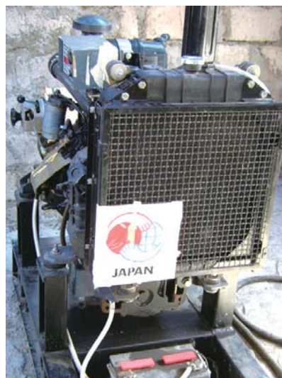
日本政府が供与した揚水ポンプ(イエメン)
