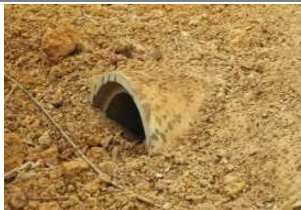
⑧完工確認時に埋まりかけの排水管(2012/01/20) 今般調査では確認できなかった
