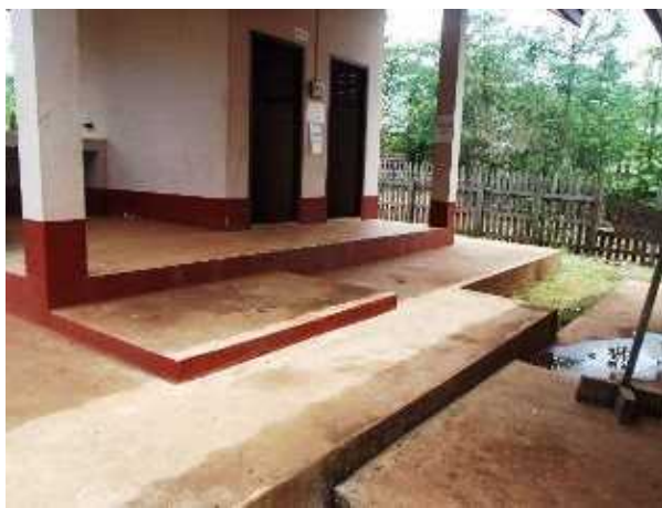
⑪トイレ周辺 段差が多いため、バリアフリー構造が望ましい
