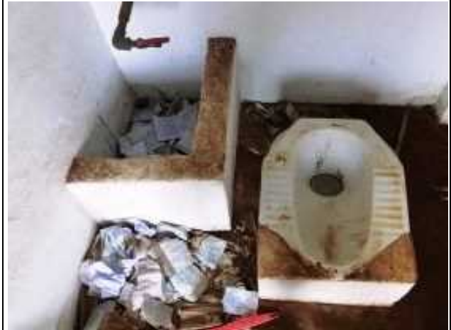
⑧生徒用トイレ 水道はあるが水は通っていないため、使用されておらず清掃もされていない
