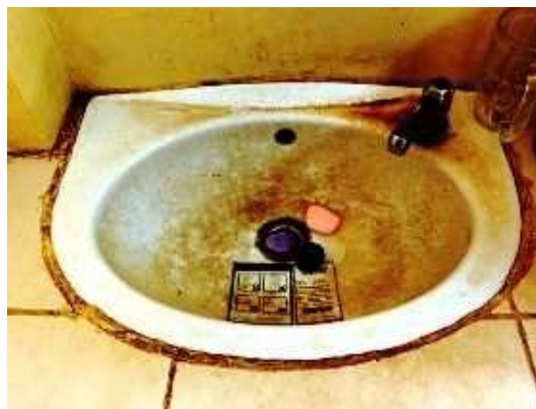
⑧手洗い場 掃除されておらず、汚れがこびりついている
