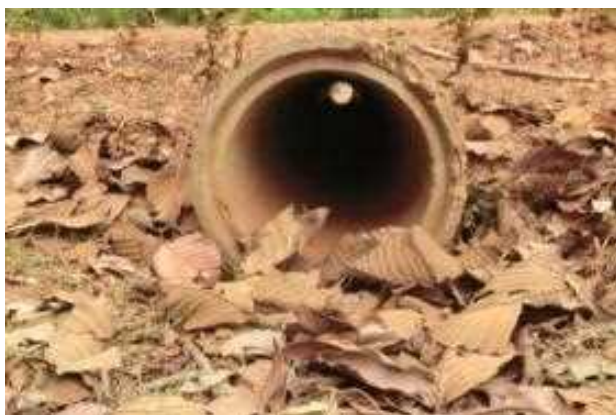
⑦今般の調査で確認できた排水管
