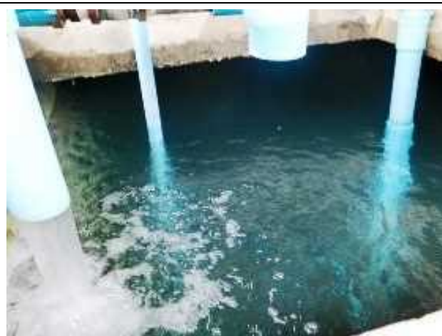
⑫ドンドックマイ村の民間給水施設 湖を水源としており、処理過程で濾過している
