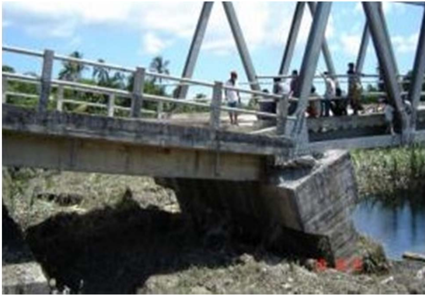
2005年ニアス島地震における橋梁の液状化被害
