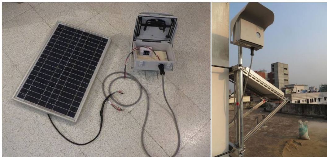
アライアンス・フォーラム財団 事務所屋上設置
