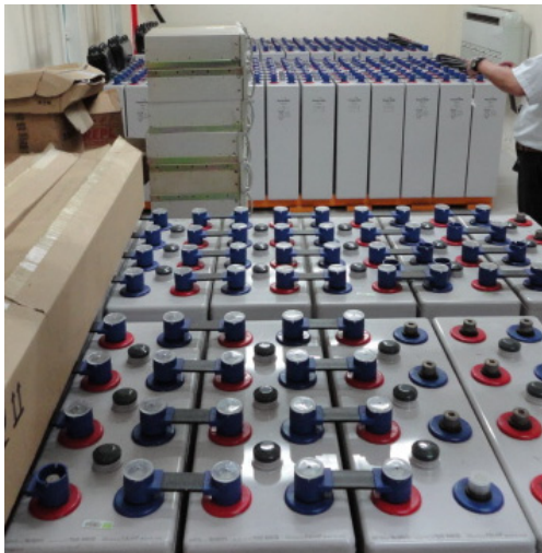
Safaricom 社の待機電源室 （産業用鉛バッテリー）
