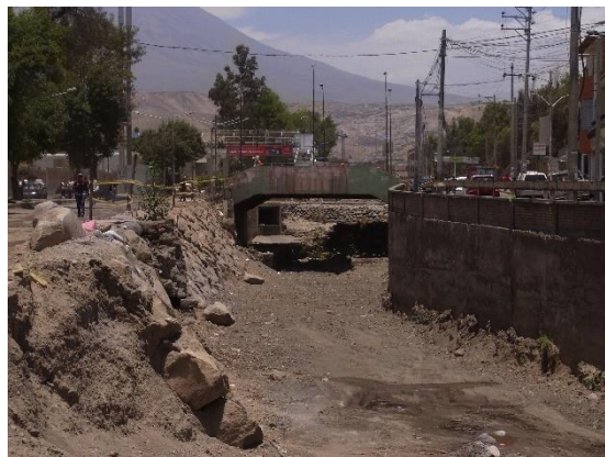
鉄砲水被害の現場 (アレキパ州市街地)
