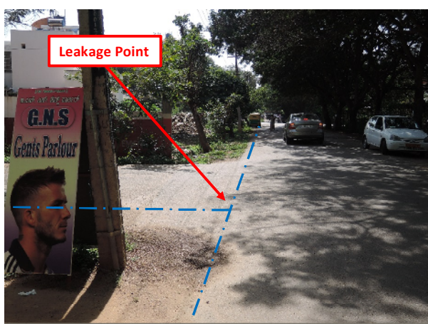
調査により特定した漏水箇所（１）
