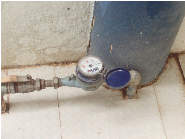
各家庭に設置されている水道メーター
