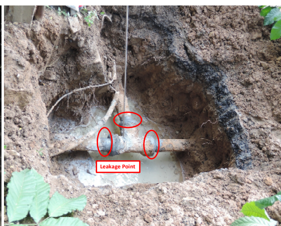
調査により特定した漏水箇所（２）
