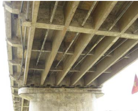
写真 3-2-10 外ケーブル (No. 10 Da Phuc)
