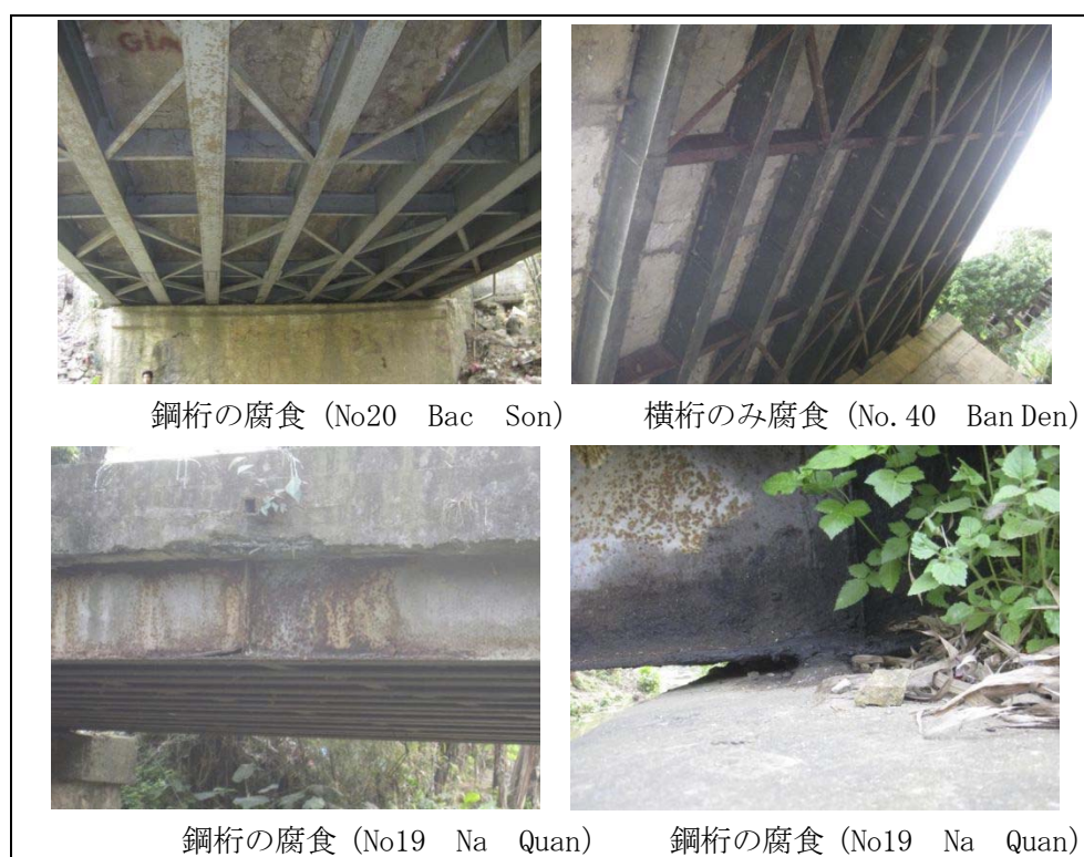
図 3-2-39 損傷写真（鋼橋の主桁）
