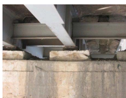
写真 3-2-23 支承（杓座）のひび割れ (No. 9 Cầu Khương Đình)
