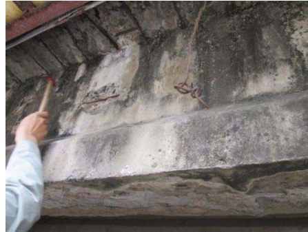
写真 3-2-15 主桁の鉄筋露出 (No. 13 Cầu Dịch Vọng)
