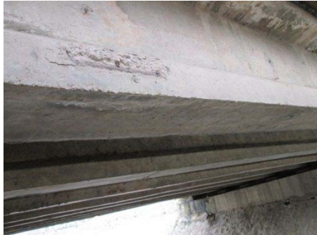
写真 3-2-14 主桁の鉄筋露出 (No. 6 Cầu Sét)
