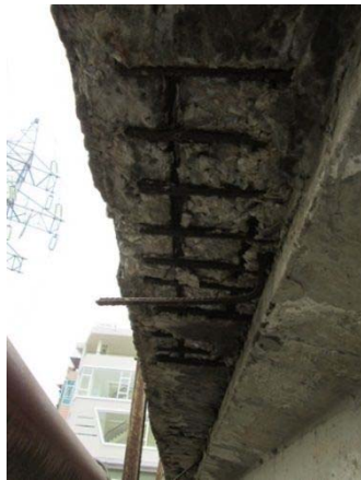
写真 3-2-16 床版の鉄筋露出 (No. 6 Cầu Sét)
