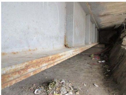
写真 3-2-18 主桁の腐食 (No. 8 Cầu Lũ)
