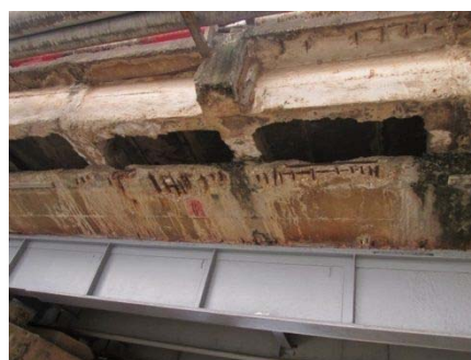
写真 3-2-19 床版の鉄筋露出 (No. 9 Cầu Khương Đình)
