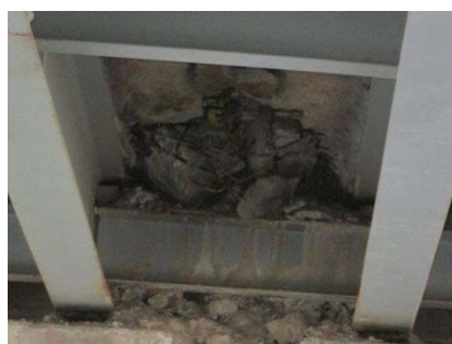
写真 3-2-22 床版の局所的な損傷 (No. 8 Cầu Lũ)
