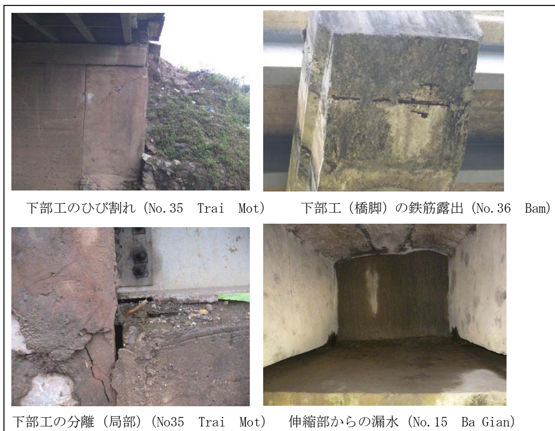
図 3-2-43 損傷写真（下部工）
