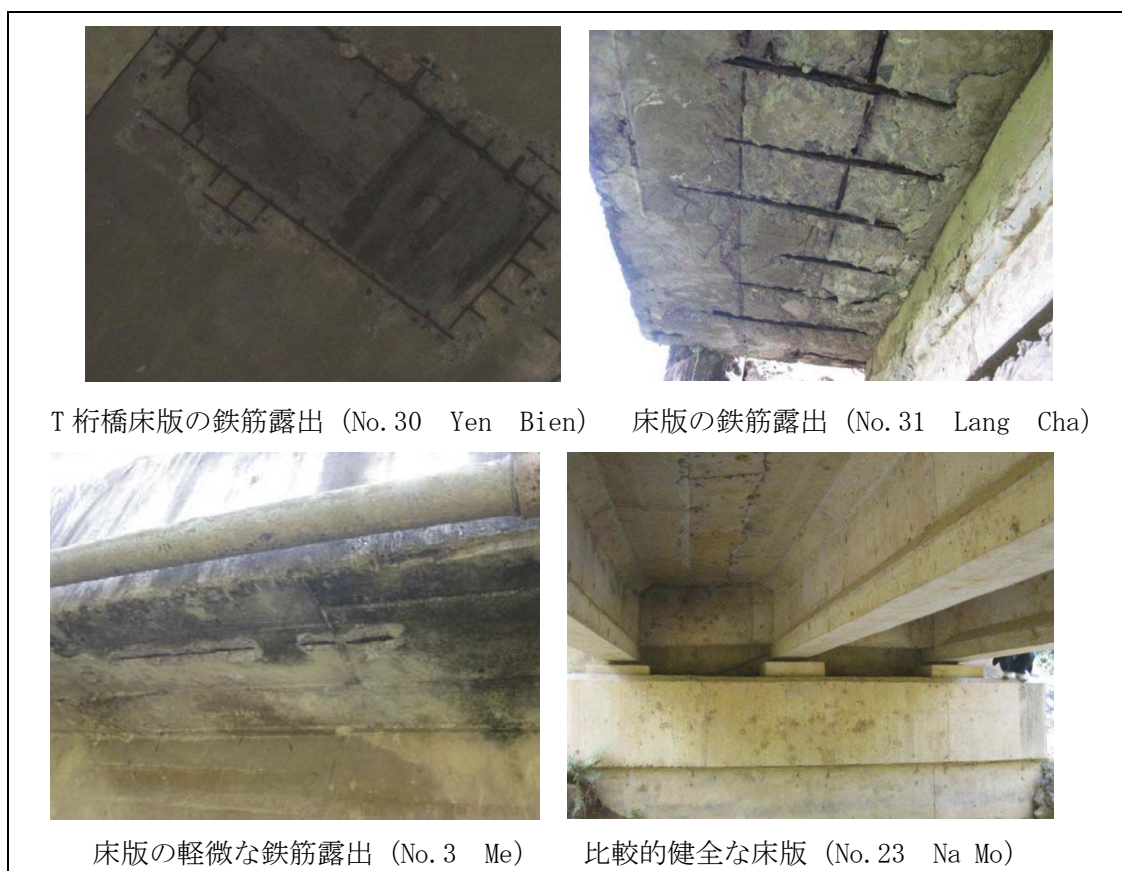
図 3-2-42 損傷写真 (コンクリート橋の床版)
