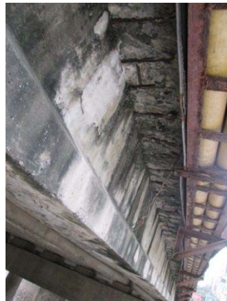
写真 3-2-17 床版の鉄筋露出 (No. 13 Cầu Dịch Vọng)
