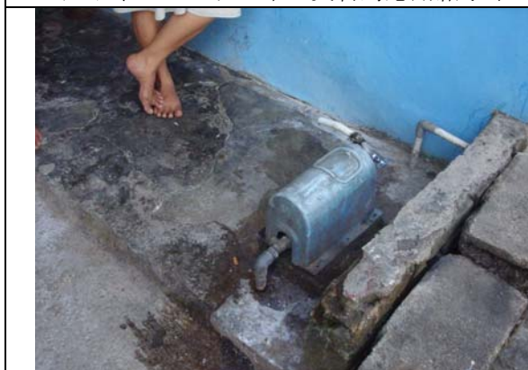
インドネシア・パダン市中心部の水が出ない水栓
