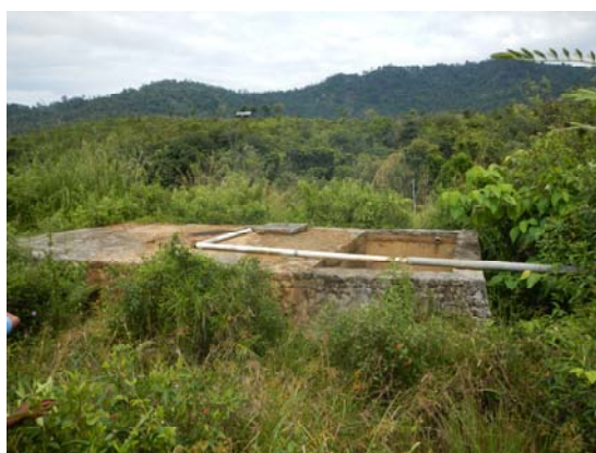
図 1-1 遺棄された PAMSIMAS 設置の簡易砂ろ過施設
