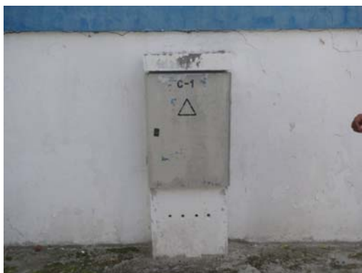
図 3-2-1.2 道路上にある配電盤
