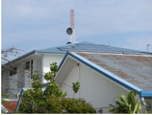
(c) 公民館屋根の PV パネル
