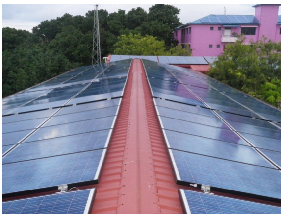
Villingili 島小中学校 PV システム調査
