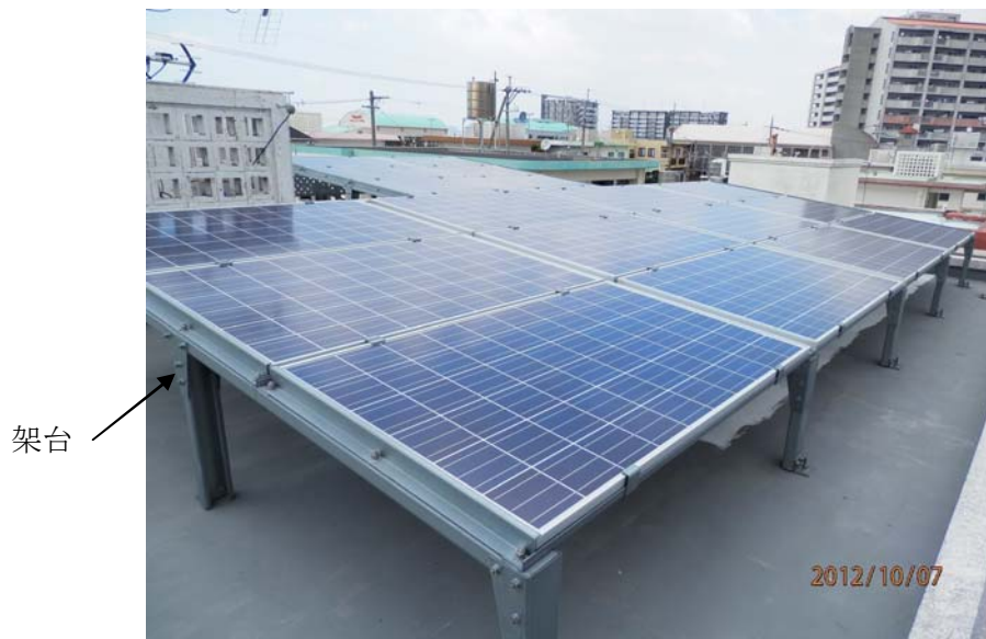
図 1-2-3. 3 平屋根に設置された PV システムの一例 (沖縄県)
