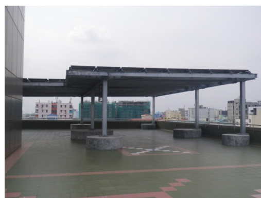
(b) STELCO Office 屋上の PV パネル・架台
