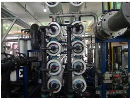
排水処理の RO 膜装置
