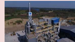
廃棄物発電設備 (ミャンマー・ヤンゴン)
