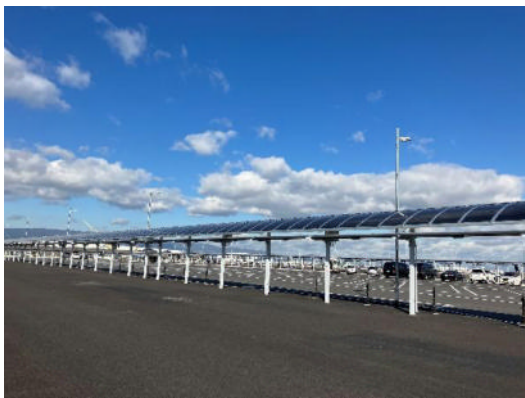
大阪・関西万博 交通ターミナルに設置されたペロブスカイト太陽電池(写真:経済産業省)
