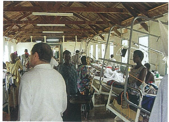
女性病棟:築60年が経ち、老朽化が著しい。 雨漏りと木造トラスの傷みが目立つ。
