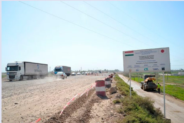
工事中の道路。道路は舗装されておらず、歩道も設置されていなかった。（写真：JICA）
