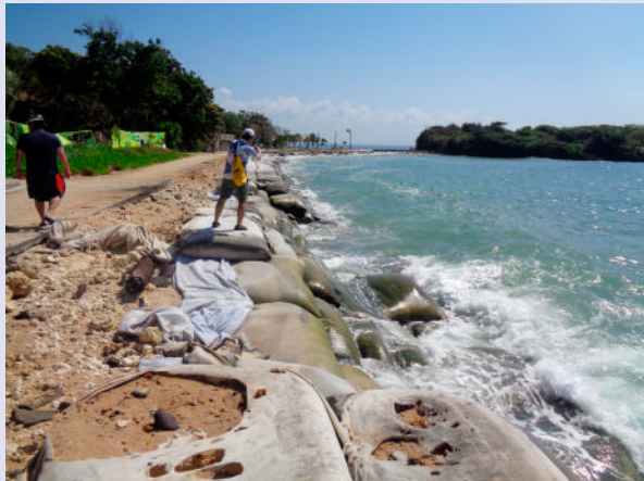
事業実施前、護岸の損傷・崩壊が目立つヌサドゥア海岸（写真：日本工営株式会社）
