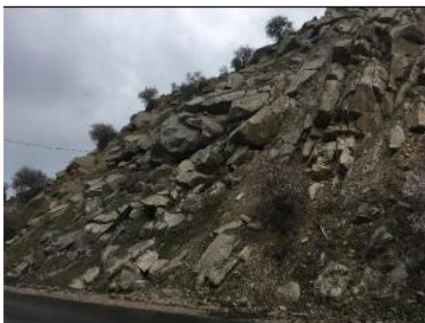
対象道路落石危険斜面
