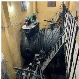
写真 鉄管弁 (サージタンク直下)
