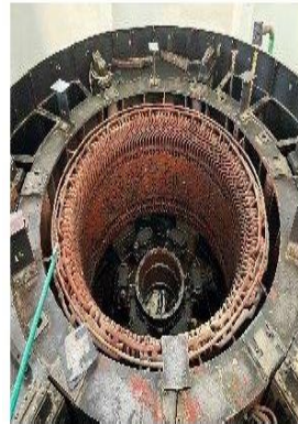
写真 発電機固定子
