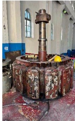
写真 発電機回転子
