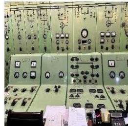
写真 発電所・変電所操作盤
