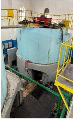
写真 発電機外景
