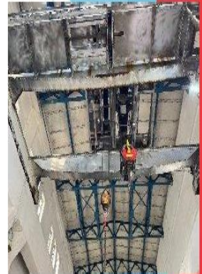
写真 天井クレーン
