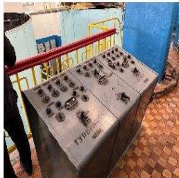
写真 水車発制御盤
