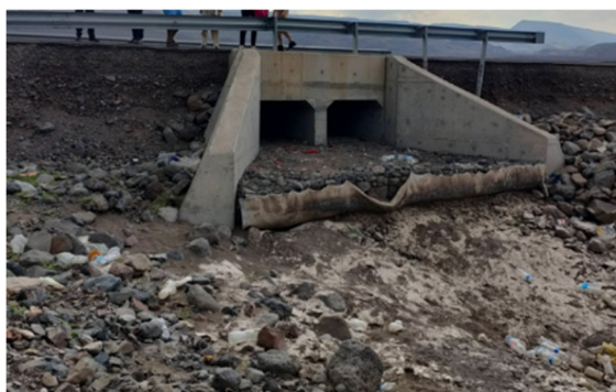
⑮ 日本工区（2022洪水被災地）
