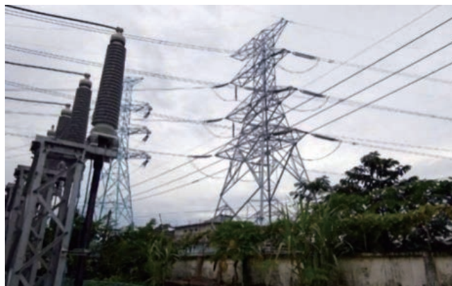
全国送電網整備事業：バングラデシュ全域における変電所及び送電線の新設・増設 (出典：JICA、ODA 見える化サイト)
