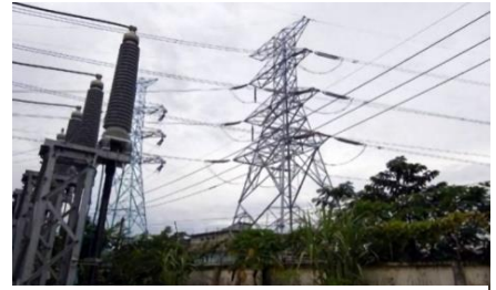
写真:全国送電網整備事業: Bangladesh全域における変電所及び送電線の new 設・増設
