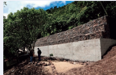
斜面災害対策管理プロジェクトを通じ整備された落石防護壁
