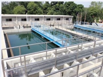
完成した浄水場全景 (写真：株式会社TECインターナショナル)
