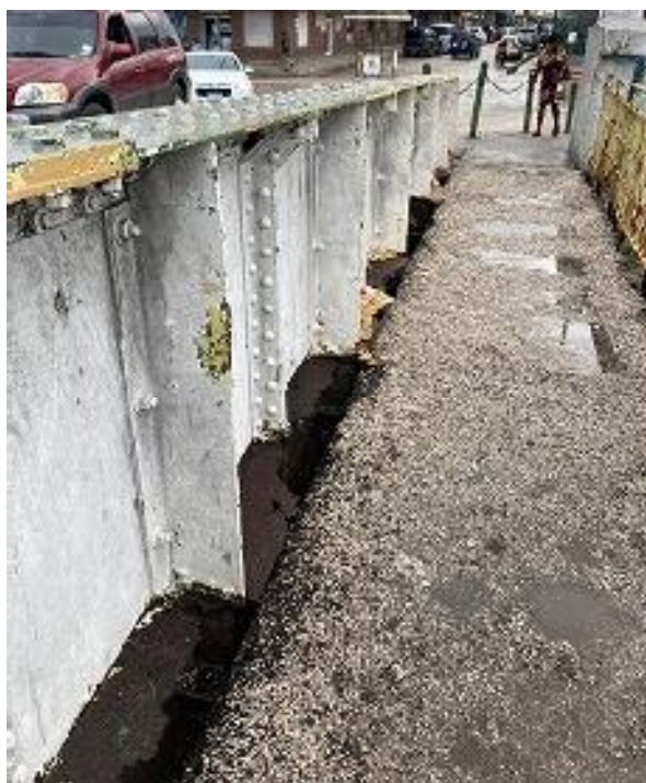
老朽化した橋
