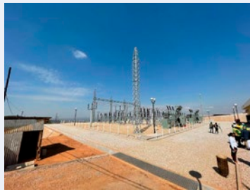
新設されたガンギ変電所と配電線
