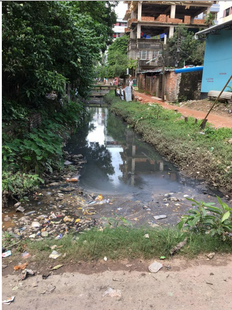
チョットグラム：汚水が流出した排水路
