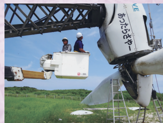
波照間島（八重山郡竹富町）での実機研修では、稼働中の風車を活用してのレクチャーを行った。
