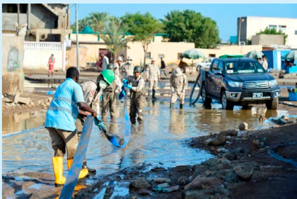
ジブチ当局のスタッフとも協力して中学校での排水作業を行う自衛隊部隊（写真：防衛省）
