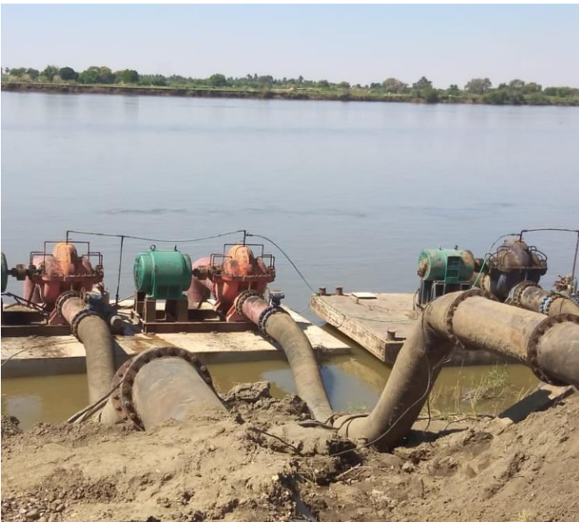
ナイル川からの取水ポンプ設備②
