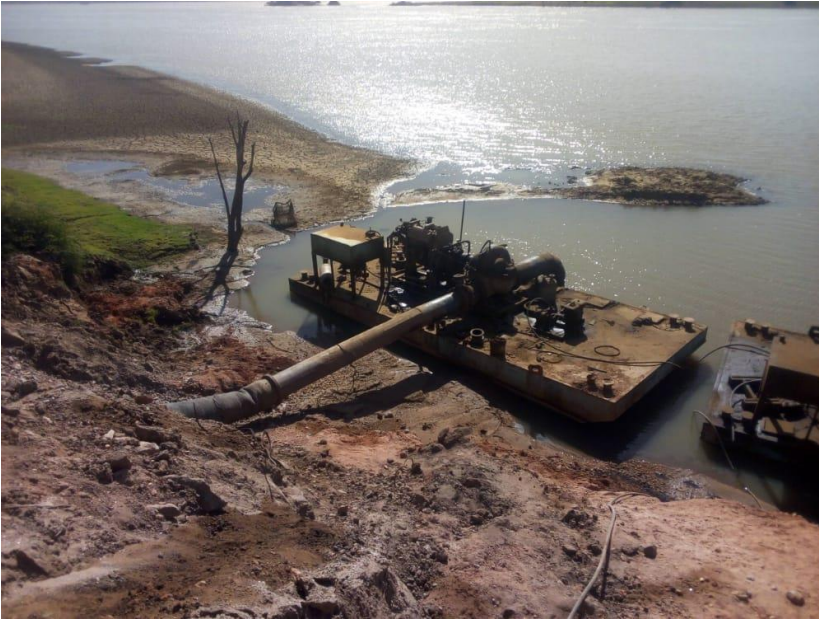
ナイル川からの取水ポンプ設備①
