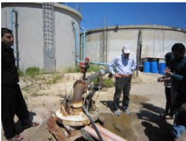
ジェニン市所有の井戸と配水タンク。老朽化が進んでおり、改修が必要。
