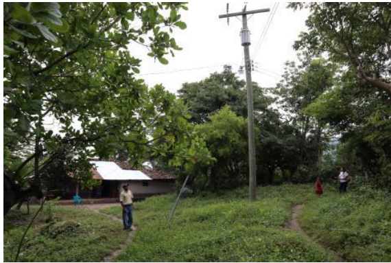
村内に設置された電柱と電線の様子2
