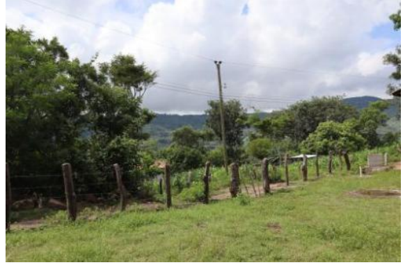
村内に設置された電柱と電線の様子1
