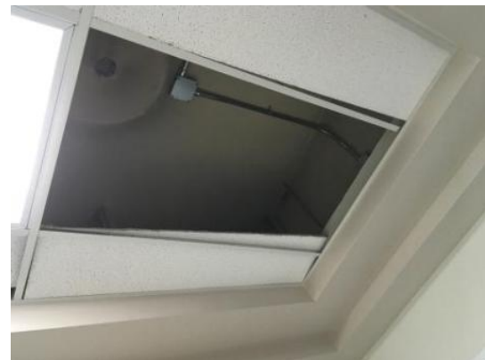
天井板がなくなった状態で放置された箇所
