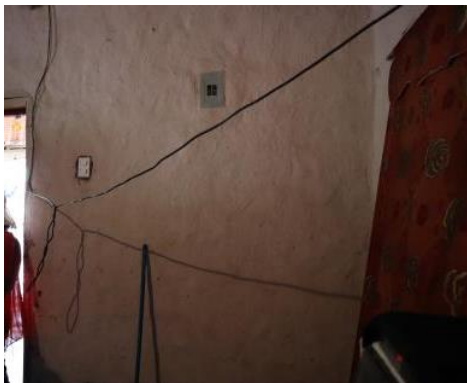
住民宅内の電気スイッチ
