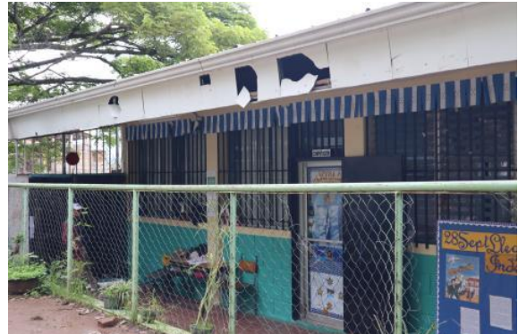
ボール遊びにより破損した屋根の一部
