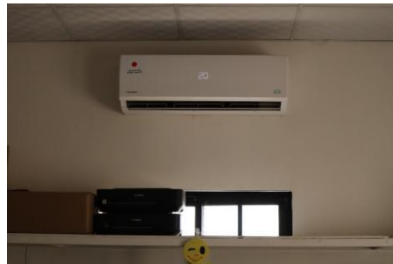
空調機器にも日章旗ステッカーが貼付されている
