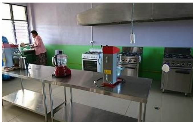
今回の支援で設置したオープン付コンロ
