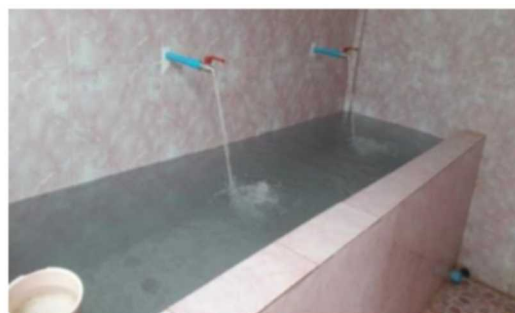
学生寮に付随した水浴び場 (2018年8月、モクソー中等学校)
