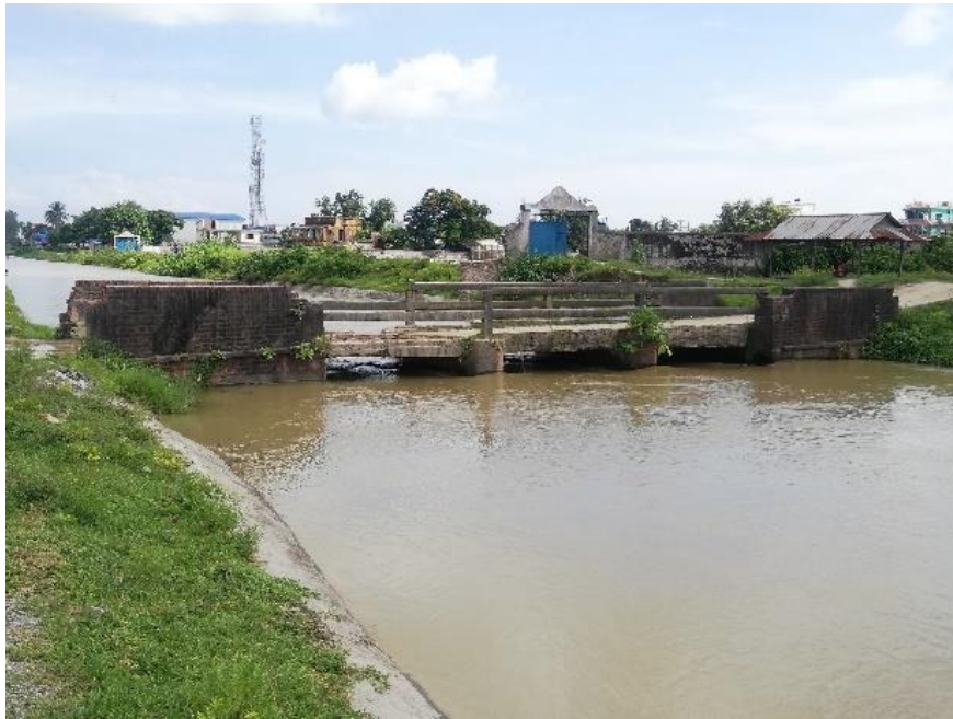
水路横断橋（破損箇所）
