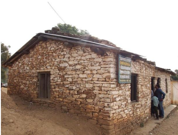
強風により、屋根が一部吹き飛ばされている。 (ディパエル-シルガディ市 Durga 小学校)
