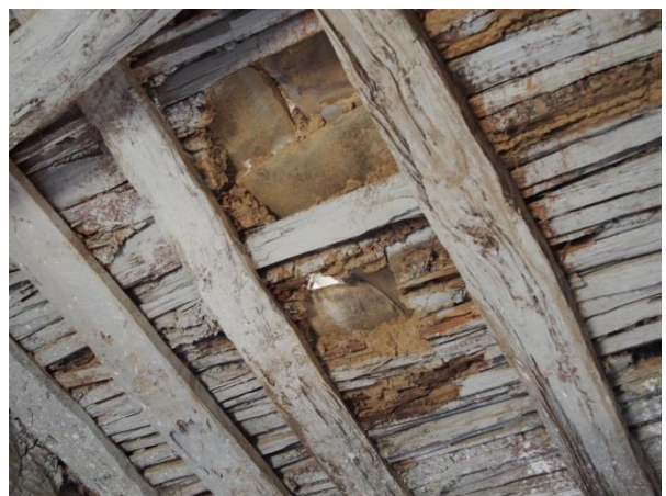
教室の天井。薄石の屋根が重く、小さな揺れでも教室に落ちる危険がある。
