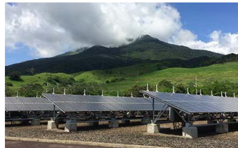
日本の協力により設置された太陽光パネル
