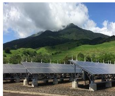
日本の協力により設置された太陽光パネル （コスタリカ）
