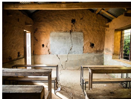
亀裂が入ったシタ・ダルマ校(屋内)
