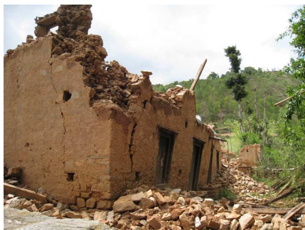
倒壊した家屋
