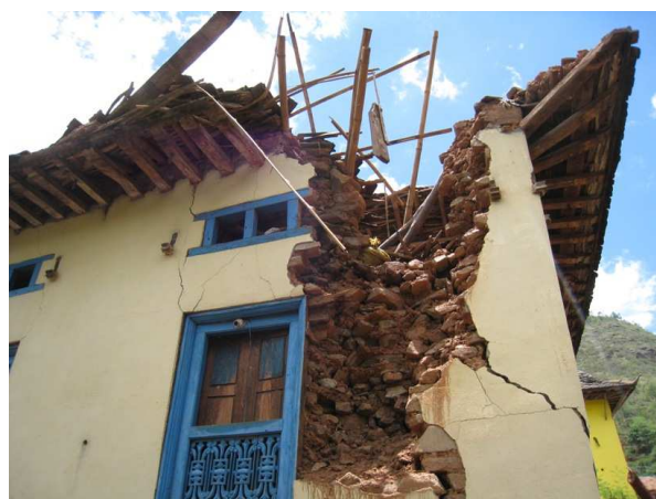
損壊した家屋
