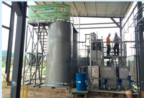
パームオイル廃液を処理し、燃料となるメタンガスを発生させるための廃液処理装置（写真提供：白井義人九州工科大学教授）
