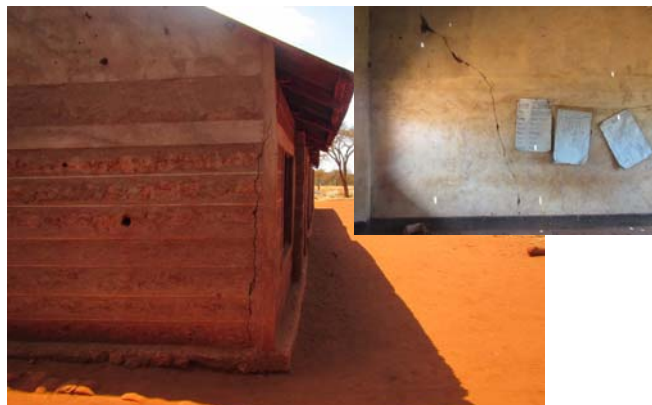
教室の背面が、土壌浸食で基礎が浮いた状態で、壁に垂直方向の亀裂が確認され、リテンド壁による土壌保全と教室構造補修のニーズを確認した。(ムカメニ小学校:2016年9月17日撮影)
